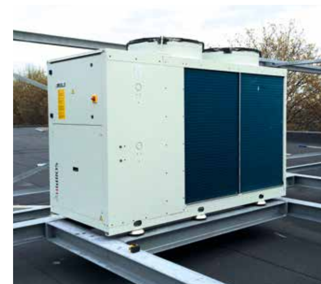
Installatie warmtepomp met dakopbouw.
