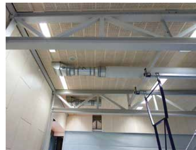
Ventilatie door middel van textiel luchtkanaal.
